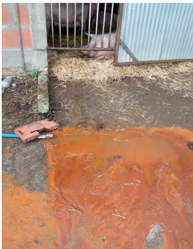
Au fil du temps, les canalisations s'entartrent et se recouvrent d'un biofilm.
